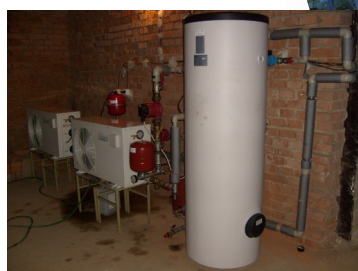
Instalace tepelných čerpadel celkem: 110 315 Kč Fotogalerie: http://goo.gl/iu1Mm
